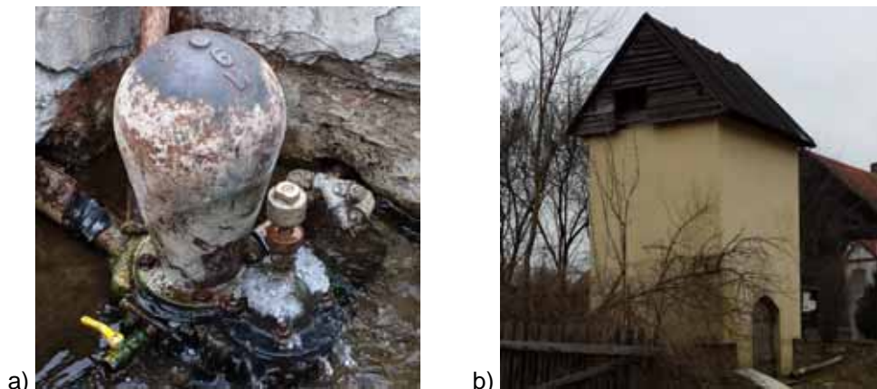
Fot. 1. System dystrybucji wody we wsi Kajny: a) taran wodny, b) wieża ciśnieniowa (fot. D. Grygo)
